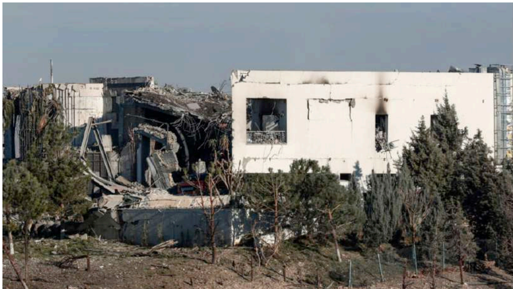
Une habitation détruite par une frappe iranienne à Erbil, le 16 janvier 2024. © Safin Hamid, AFP
